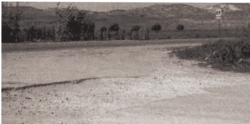
UNA DELLE STRADE RURALI CHE NECESSITANO DI INTERVENTI
